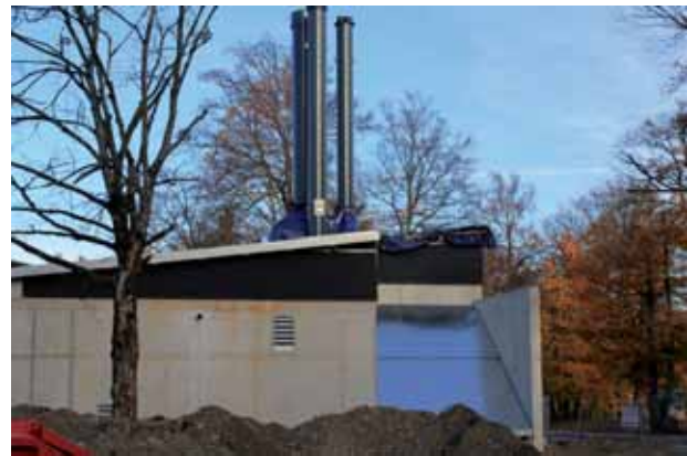
Foto: Heizwerk Geretsried
